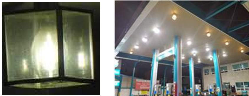
[그림 3] 노출형 조명기구 형태 및 설치 사례
